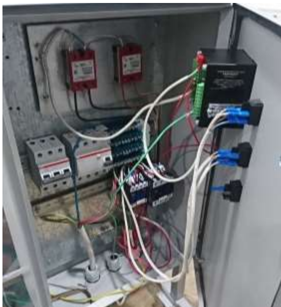
Рисунок 9 –Набор элементов электроники и автоматики внутри щита
